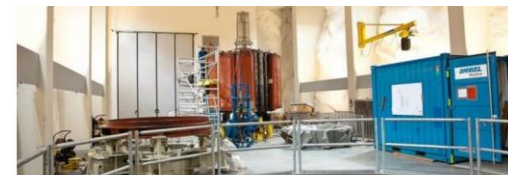
- Ved hjelp av avanserte regulatorer og algoritmer, oppfører den seg som en sjakkspiller, som gjør fremtidige trekk, skriver forskeren (Foto: Jan Erik Olsen / Skagerak Energi)
